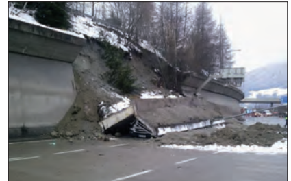
Déformation, fissuration ou rupture d'ouvrages de soutènement
