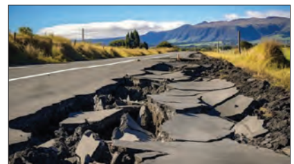
Affaissement, fissuration ou effondrement partiel ou complet d'infrastructures (routes, chemins de fer, réseaux enterrés ou aériens, barrages, ...).
