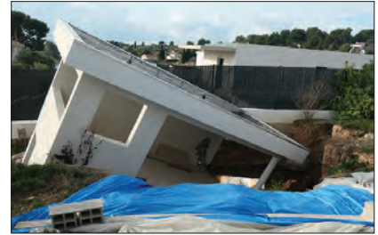
Fissuration ou effondrement complet de constructions
